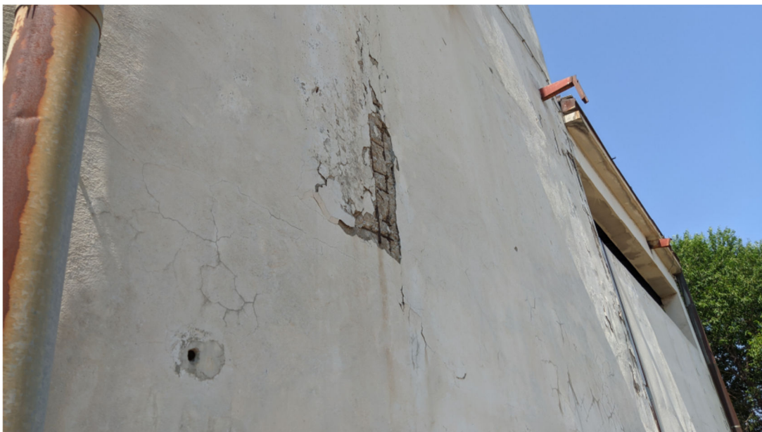
Zgrada 2 - oštećenje na vanjskom AB zidu
